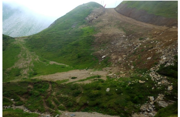
Dissesti attuali accanto alle piste della San Domenico costruite nella valle Bondolero fino ad allora integra
